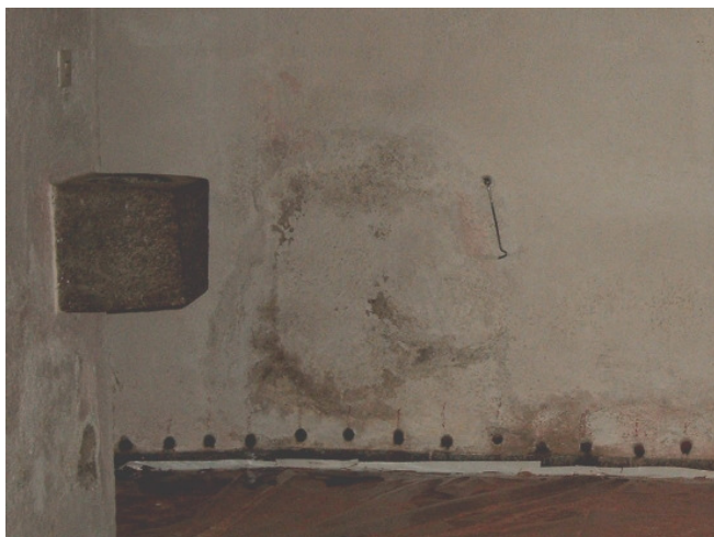
Flächiger Schimmelbefall an Innenwänden
